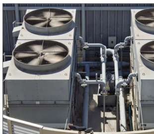
FAN AND PUMP
